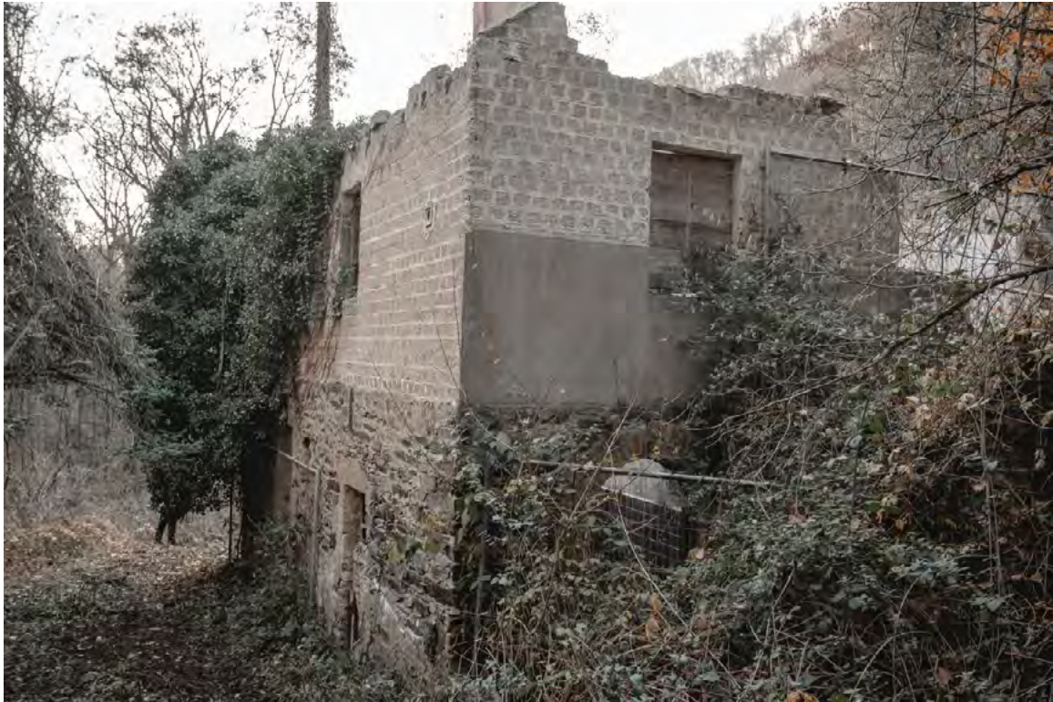
(Foto Blotzki 2020) Das ist die Ruine der durch einen Brand zerstörten Betriebswohnung heute.
